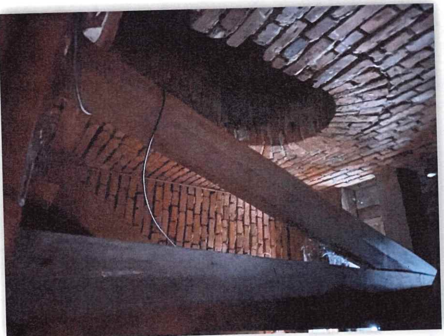
Fot. 6. Widok na wyższą część wieży kościoła wraz z wejściem na poddasze
