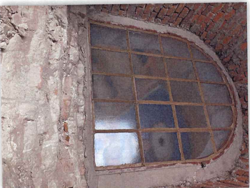
Fot. 2. Okno w wewnętrznej części kościoła widoczne ubytki konstrukcji - OW.2W EW
