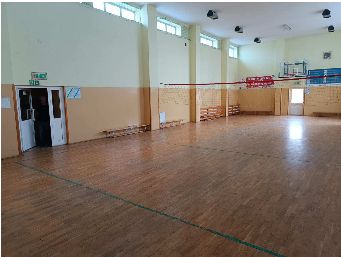
Fot. nr 2 – istniejąca sala gimnastyczna, widoczne zużycie istniejącego parkietu.
