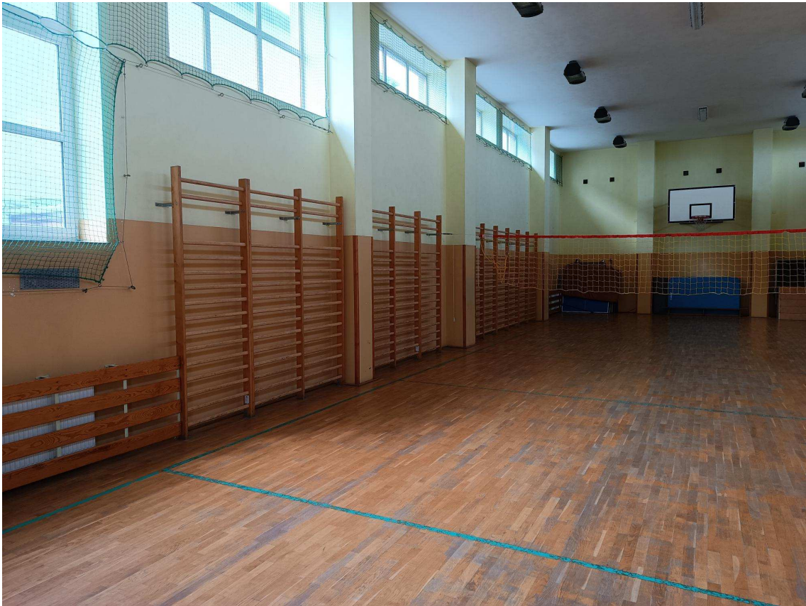
Fot. nr 3 – istniejąca sala gimnastyczna, widoczne zużycie istniejącego parkiet, drabinki gimnastyczne i osłony grzejników do zdemontowania i ponownego założenia.
